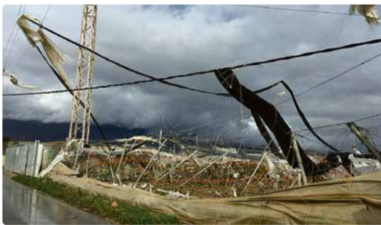
Invernadero derribado por el fuerte viento. /FHALMERÍA
