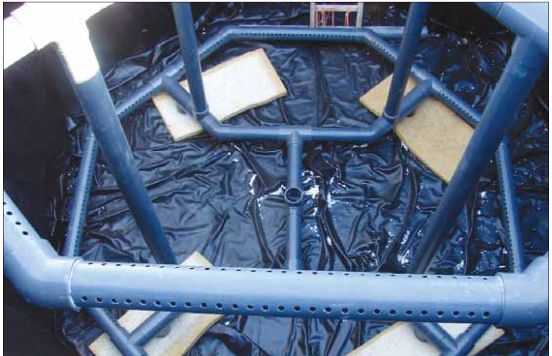
Doble difusor octogonal en el tanque de almacenamiento.
